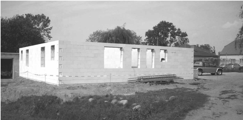
Die Seitenwände des neuen Sportlerheimes stehen schon, bald kann die Decke gegossen werden
