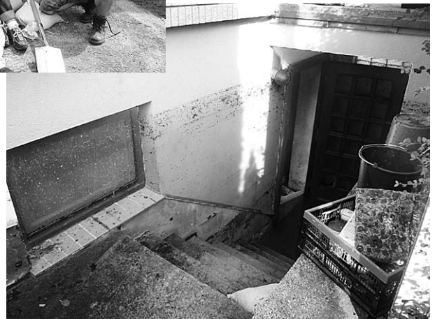
Die Schmutzmarken zeigen den höchsten Wasserstand
